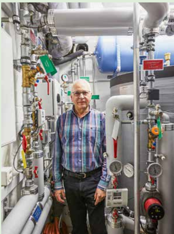
René Broders Heizung bietet viel Energieeffizienz auf kleinstem Raum.
