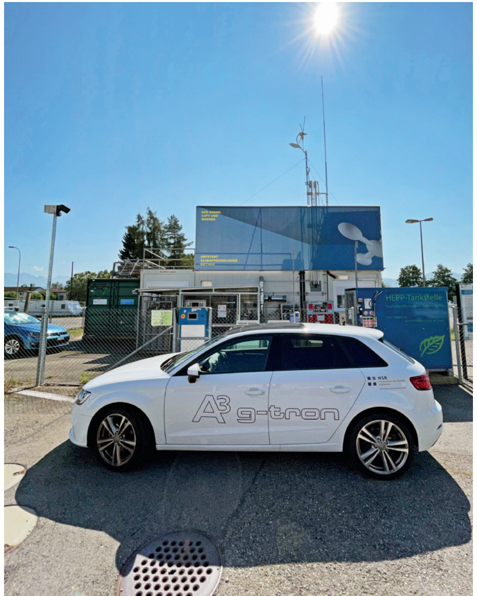
Gesamtansicht der Power-to-Methane Anlage mit Tankstelle.
