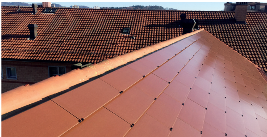
Dach vorne: Solarmodule, die wie Dachziegel aussehen.
