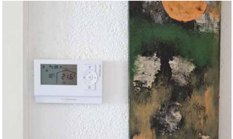
Der fein dosierte Heizkreis wird über das Raumgerät (Bild) gesteuert.
