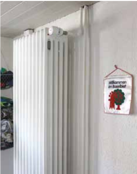
Oft hilft ein zusätzlicher Heizkörper bei der Steigerung der Energieeffizienz.
