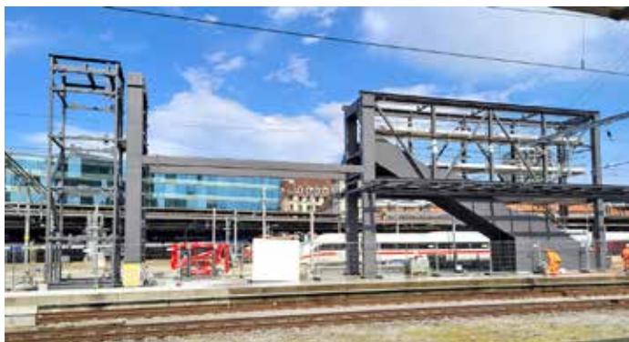
Das Joch der provisorischen Passerelle auf Gleis 11/12 mit Liftschacht und Treppenaufgang am 30. März 2023.
