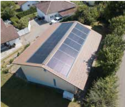
Zwei Komponenten des intelligenten Energiesystems: eine Indach-Solaranlage und eine Wärmepumpe in Bergdietikon.
