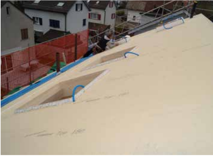
Der Dachsanierung ist im Hinblick auf die Energieeffizienz besondere Beachtung zu schenken.
