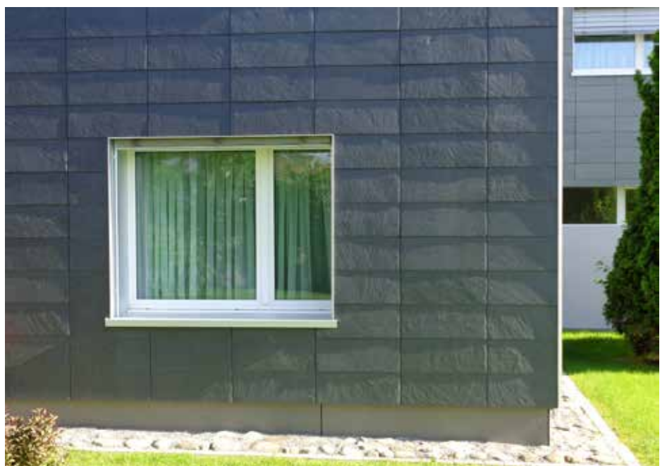
Mit einer hinterlüfteten Fassade holt man Wärme und Kälte ab, bevor sie in das Gebäude eindringen.
